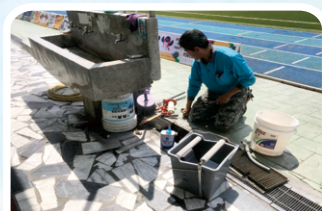
112.3.15二甲洗手臺水管破裂修繕
