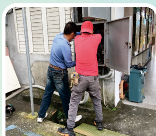
1110326既設電力改善
