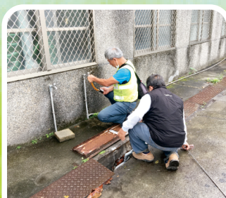
1110328自來水廠助勘察漏水
