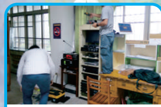
105.05.19地震預警系統 定期檢修與試播
