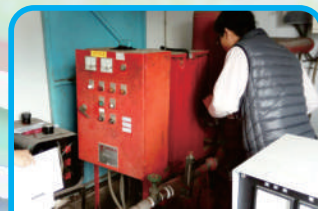
105.03.29年度消防設施 -發電機檢核與改善
