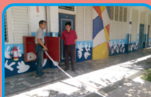
完成年度消防設施檢核與改善
