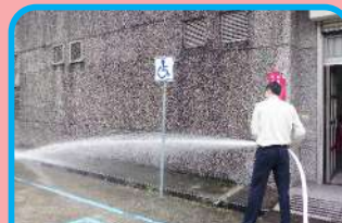
完成年度消防設施檢核 與改善
